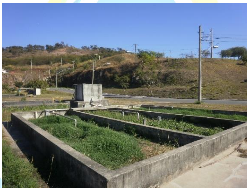
Figura 5: Wetlands para tratamento de esgoto sanitário no CePTS - UFMG/COPASA.
